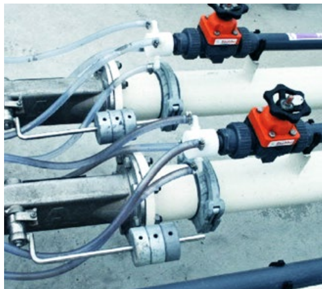
Venturiho směšovač, vyvločkování kalu přímo v kalovém potrubí
